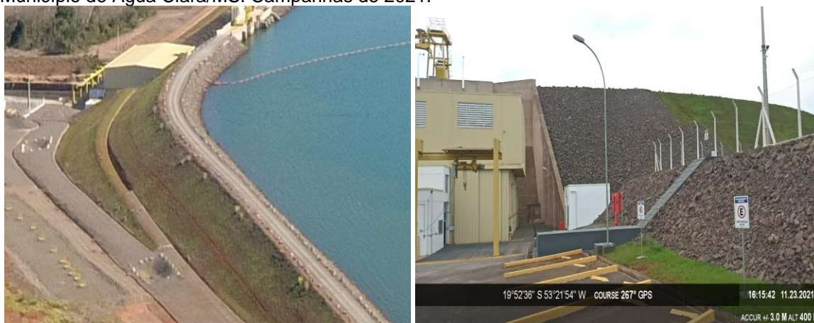
Figura 8 – Talude de contenção da PCH Verde 4A, evidenciando área gramada e cascalhada. Município de Água Clara/MS. Campanhas de 2021.
