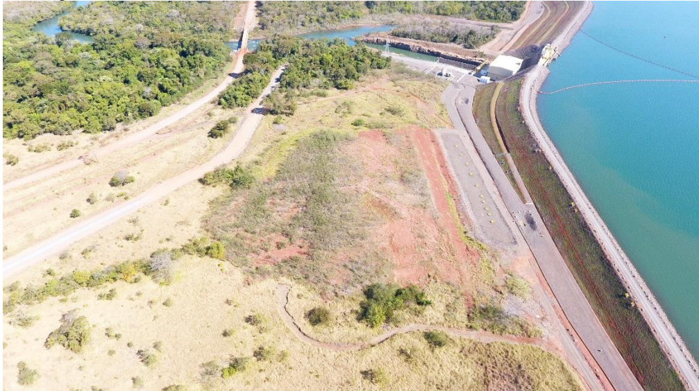
Figura 16. Imagens áreas da área de bota-fora. PRADE - PCH Verde 4A, novembro de 2021.
